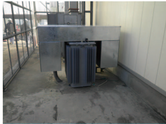
写真 2.1.17-3 更新した変圧器外観
