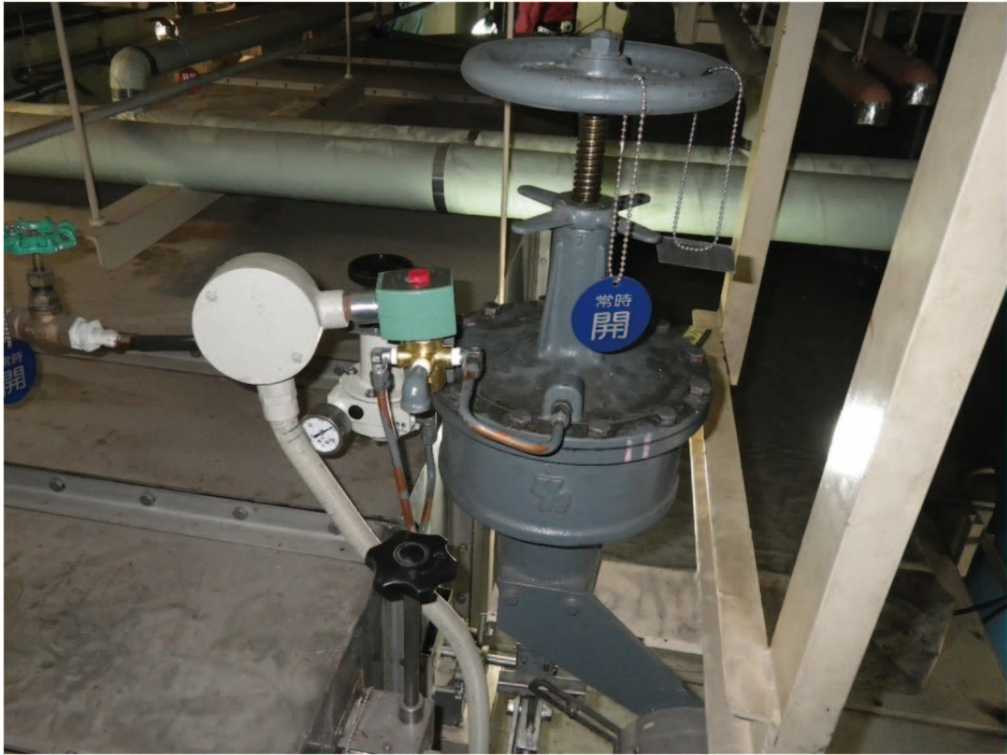
写真 2.1.1-2 JRR-3 ダンパー操作器用自動制御機器（整備後）
