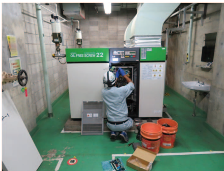
写真 2.1.8-1 空気圧縮機No.1 点検
