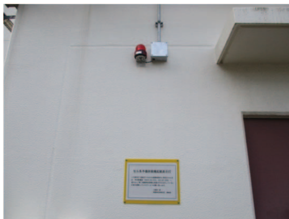
写真 2.10.3-2 屋外に設置した回転表示灯 (志賀 英治)
