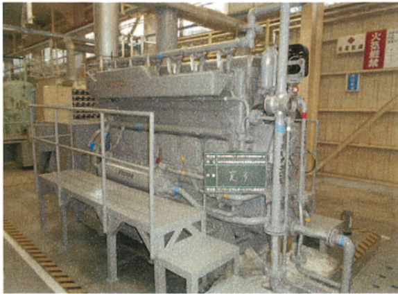
写真 2.1.4-1 ディーゼル発電機本体
