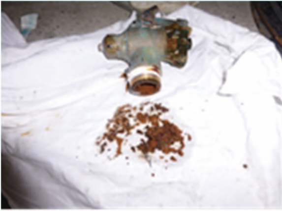
写真 2.10.4-1 ボールタップ内の堆積物
