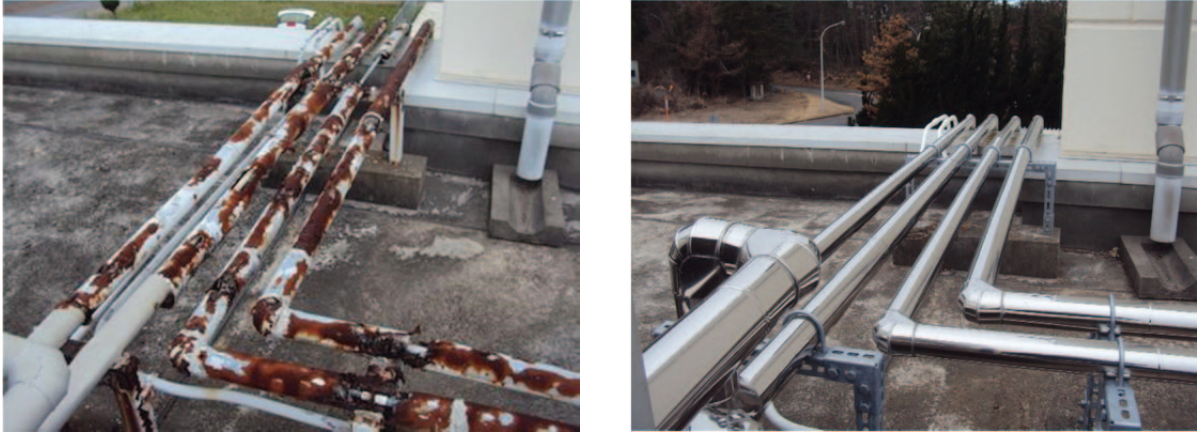
写真 2.1.16-1 二相流ループ実験棟屋上冷媒配管ラッキング補修工事
