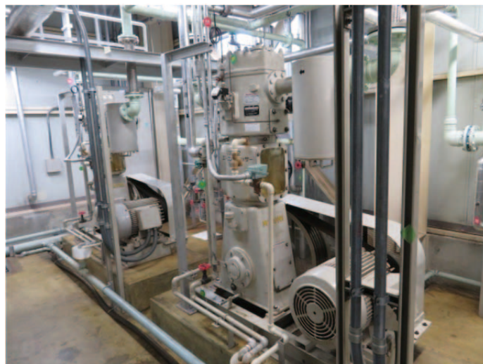
写真 2.1.12-1 空気圧縮機外観
