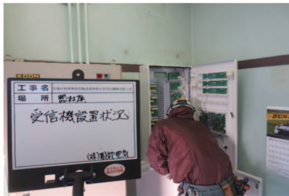
写真 2.10.8-2 火災受信機設置状況
