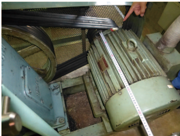
写真 2.1.7-1 異音が発生した空気圧縮機No.1Bのモーター
