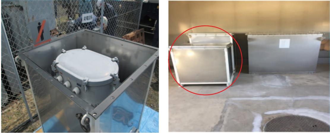
写真 2.1.15-1 更新したトランス及び保管状況
