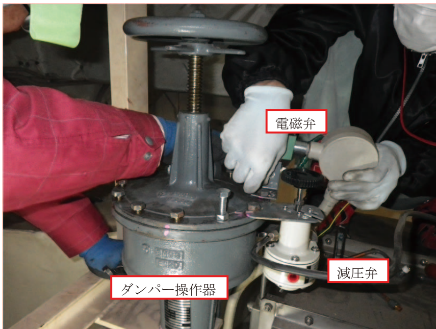
写真 2.1.1-1 JRR-3 ダンパー操作器用自動制御機器（分解中）
