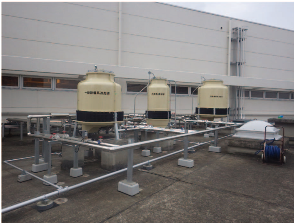
写真 2.10.1-2 JRR-3 実験利用棟空気圧縮機用冷却塔（更新後）
