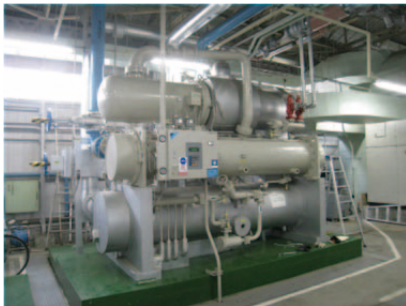
写真 2.7.2-1 スクリー冷却機
