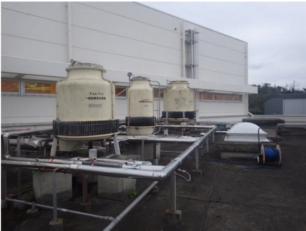
写真 2.10.1-1 JRR-3 実験利用棟空気圧縮機用冷却塔（更新前）
