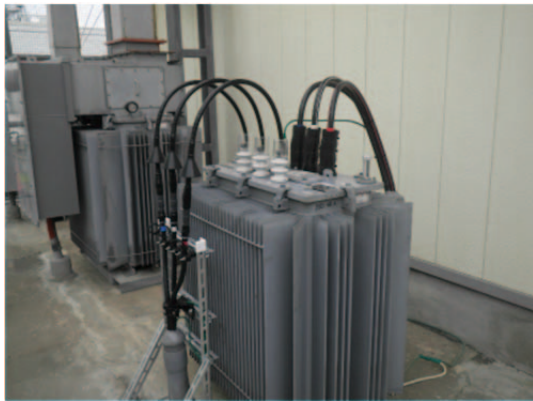
写真 2.1.17-2 仮設変圧器外観
