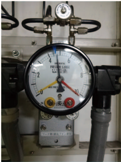
写真 2.10.2-1 接点付差圧計 （交換後）
