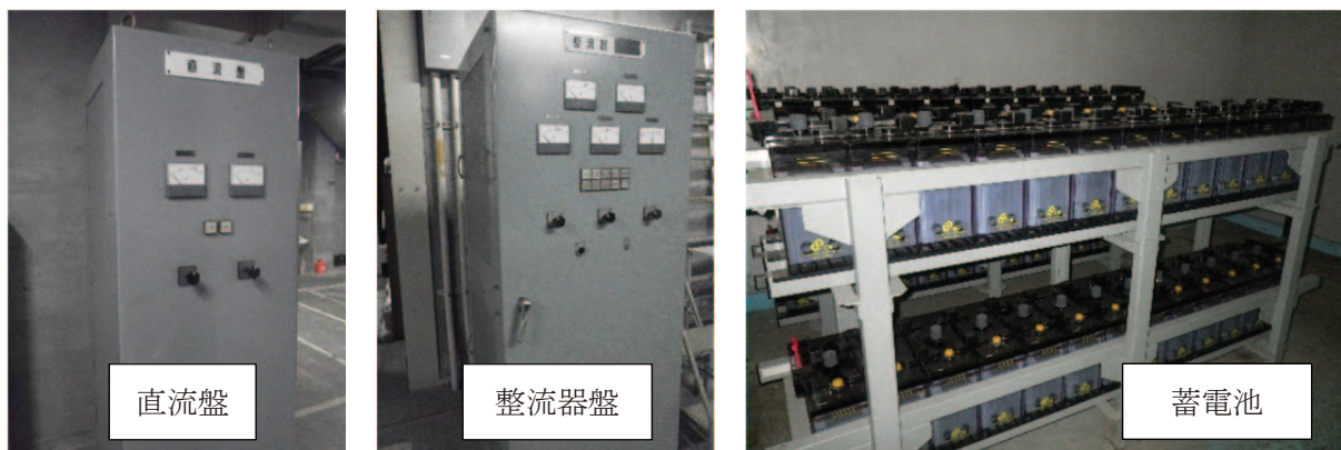
写真 2.10.6-1 直流電源設備の構成機器
